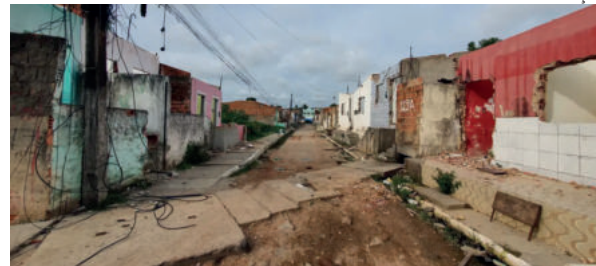
Situação é causada pelo possível colapso de mina da Braskem
