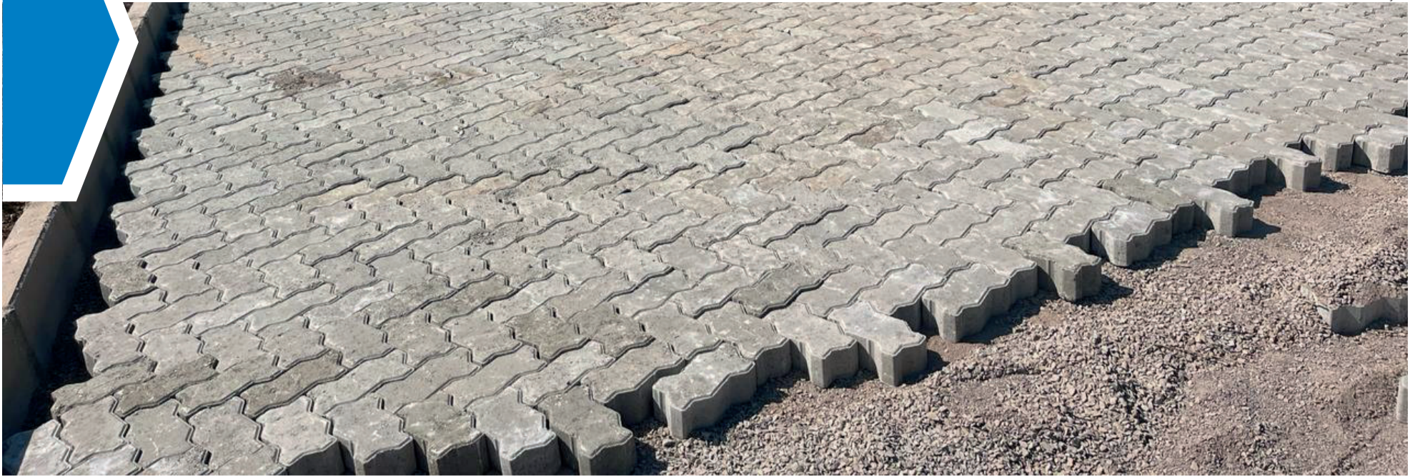
Rua Sophia Horst, no Bairro Languiru, foi uma das vias iniciadas em 2024
