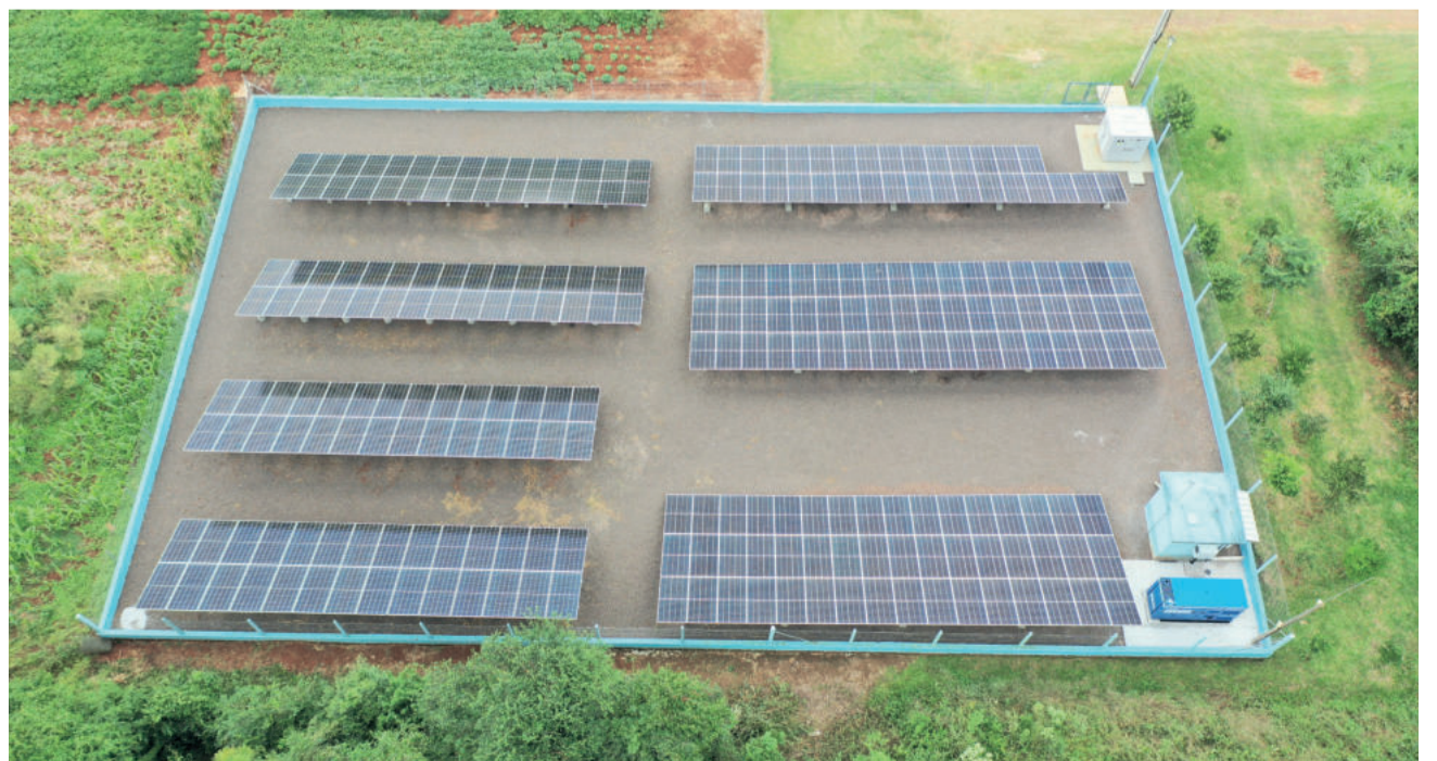
Poço da APDL tem usina fotovoltaica e gerador
