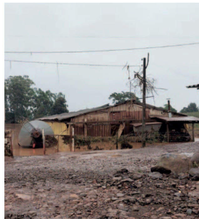
Dois galpões foram destruídos
