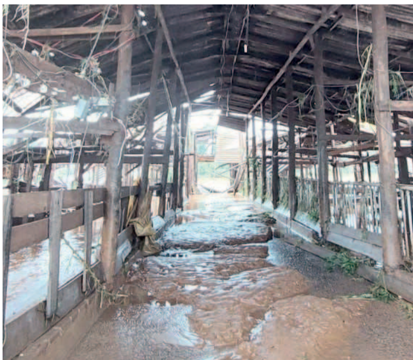
Sala de ordenha foi toda afetada
