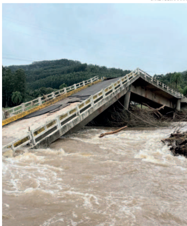
Em Poço das Antas, ponte da SUBV colapsou após a ação do Arroio Boa Vista
