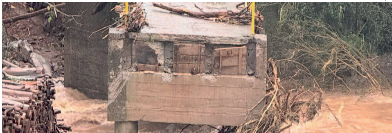
Poço das Antas: Parte da ponte na Boa Vista Alta foi arrancada
