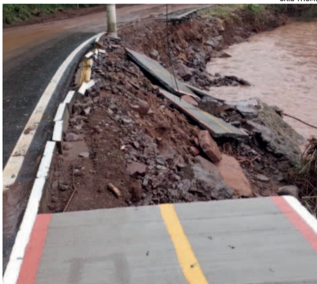
Imigrante: Obras feitas há pouco tempo foram arrancadas
