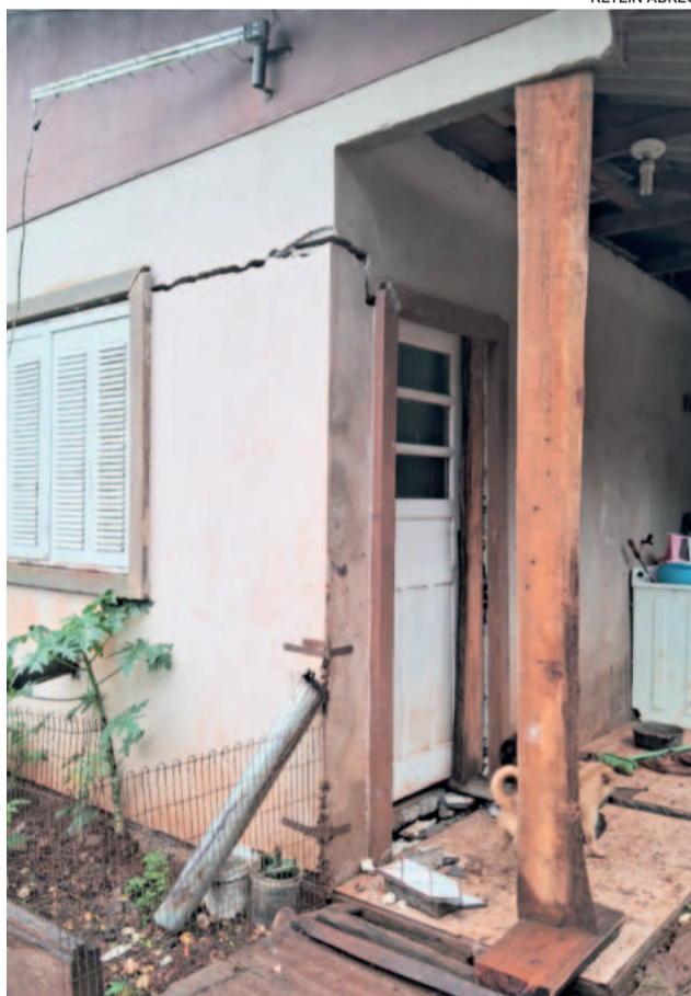
Westfália: Residência com rachaduras expressivas precisou ser deixada pela família
