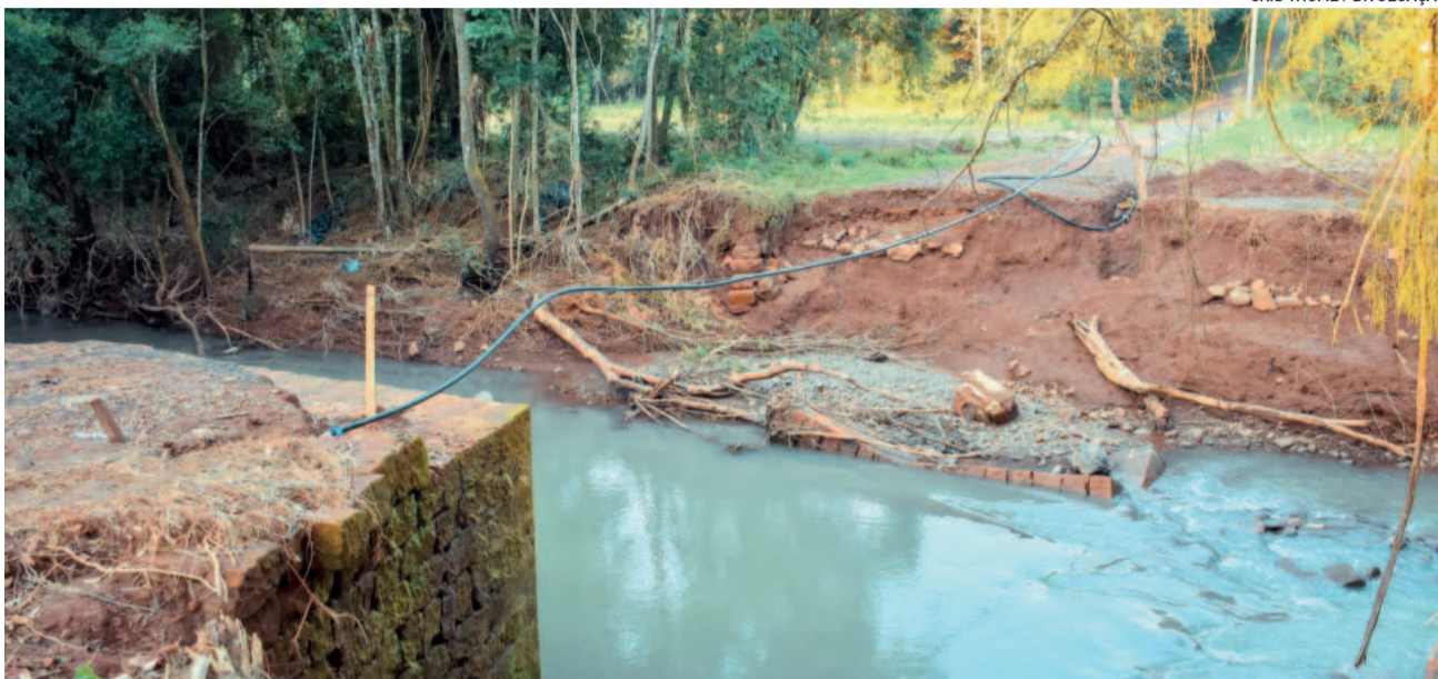
Maioria das pontes teve grande parte da estrutura levada pelas águas
