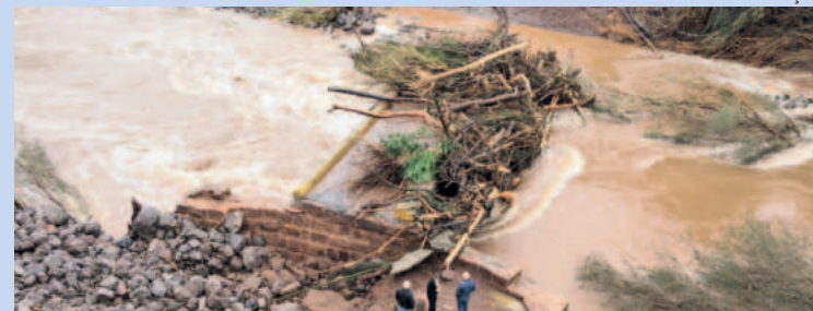
Estrutura foi afetada pela cheia do Arroio Boa Vista, em maio
