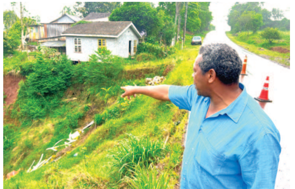
Morador de Linha Ribeiro, Adão Azeredo da Silva aguarda obra de contenção enquanto teme novos deslizamentos
