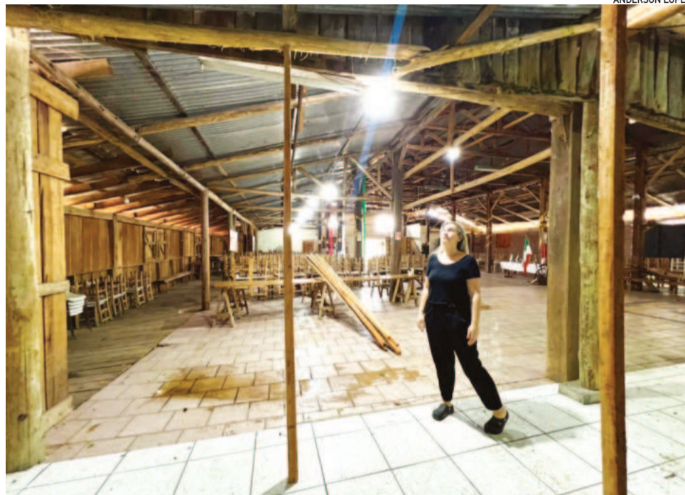
Patroa Cásia analisa estrutura do telhado, que ruiu com tempestade na madrugada de segunda-feira (7/9)
