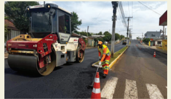
Entre as obras de infraestrutura, houve a recuperação do asfalto na Avenida 1 Leste, entre Canabarro e Languiru
